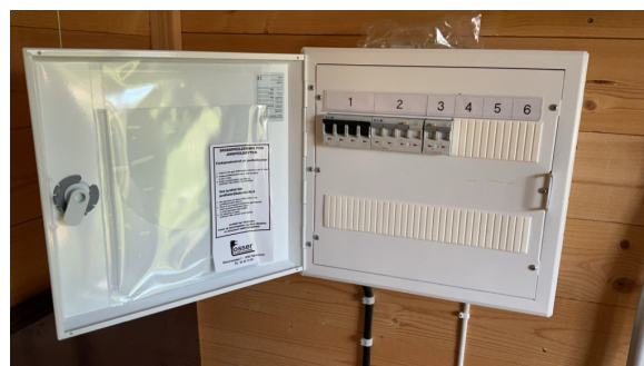
Sikringsskap i utebod.
