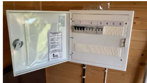
Sikringsskap i utebod.
