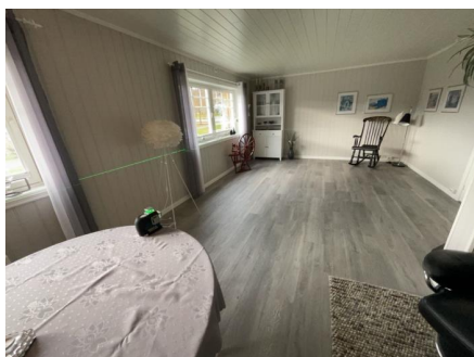
1. etasje Plassering av laser ved kontroll av stue. Det er målt 25 mm høydeforskjell gjennom rommet. TG 2. Over en avstand på 2 meter fra vedovn mot laser er det målt 10 mm. TG 2
