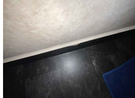
Belegg er løsnet og bør klemmes/limes
