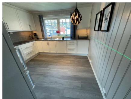
1. etasje Plassering av laser ved kontroll av kjøkken. Det er målt 17 mm høydeforskjell gjennom rommet. TG 2. Over en avstand på 2 meter fra yttervegg mot stue til senter av rommet er det målt 12 mm. TG 2
