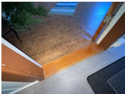
Gulvbelegg på soverom 3 har løsnet ved dør
