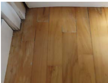
Skadet parkett i kjøkkenet
