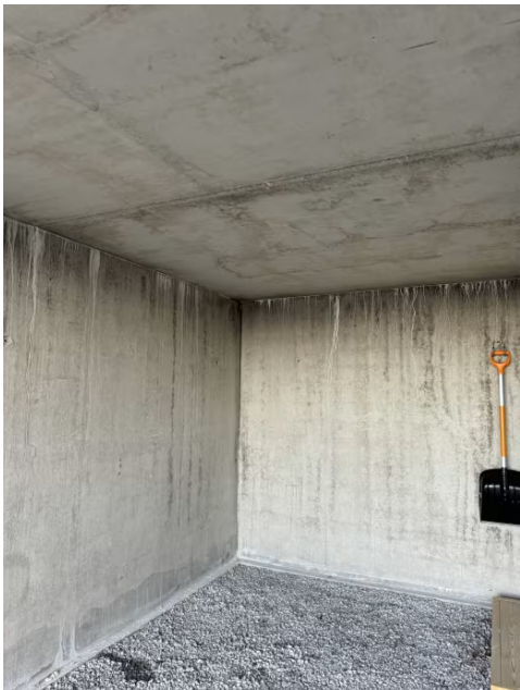
Carport med fuktmerker og salt/kalkutslag.
