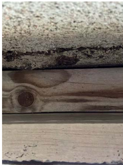
Kledningen er ikke luftet, fasader bør holdes under jevnlig kontroll for symptomer på skader.
