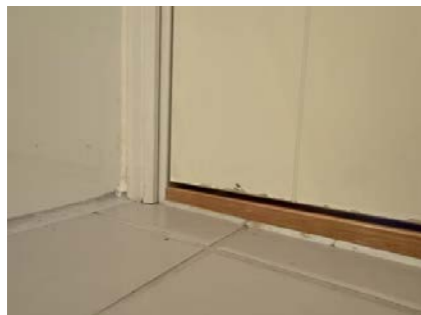
Det er fuktmerker nederst på dørblad og bom i fliser på gulvet foran dør.
