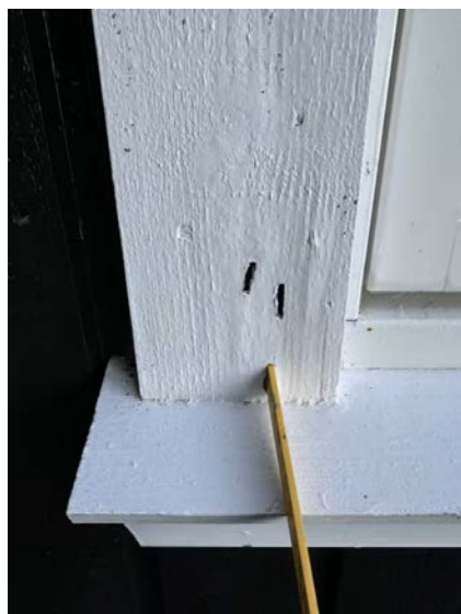
Råte i belistning.
