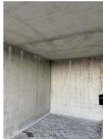
Carport med fuktmerker og salt/kalkutslag.
