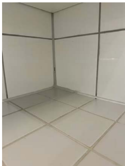
Det er slitasje og løse fliser på gulvet i hjørnet i dusjen.
