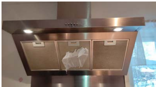
Funksjonstest av ventilator.
