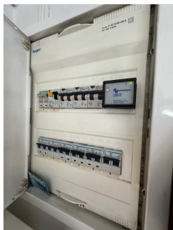
Sikringsskap med automatsikringer.
