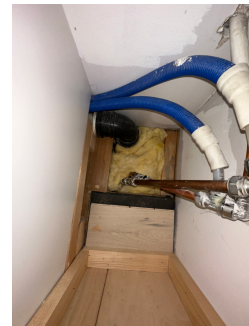
Stoppekraner plassert på soverom
