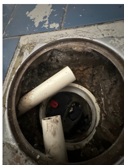
Sluk i plast plassert under dusjkabinett
