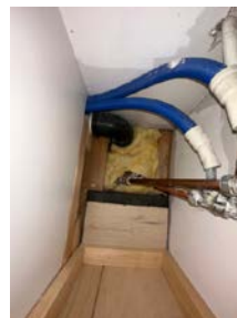
Stoppekraner plassert på soverom
