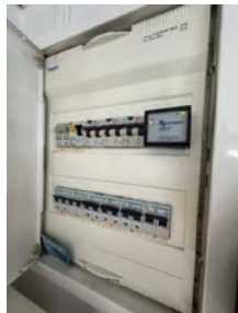
Sikringskap med automatsikringer.
