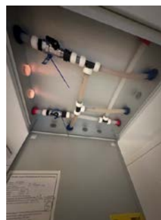
Samleskap med rørkurser og stoppekraner
