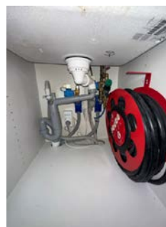
Rørapplegg i kjøkkenbenk med brannslange
