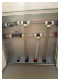
Samleskap med rørkurser og stoppekraner
