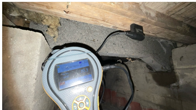
Påvist fuktprosent over 20 % der videre tiltak bør utføres på sikt.
