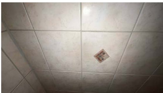
Det er påvist at flisfuger har riss/sprekker.
