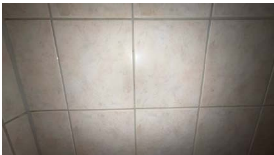
Det er påvist at flisfuger har riss/sprekker.
