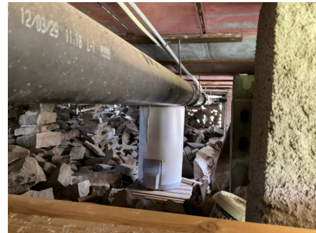
Avløpsrør merket produksjonsår
