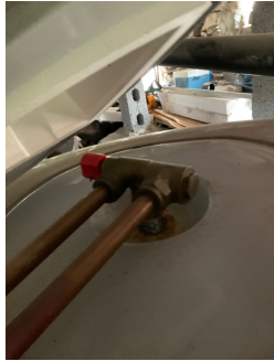
Litt rustutslag ved rørgjennomføring
