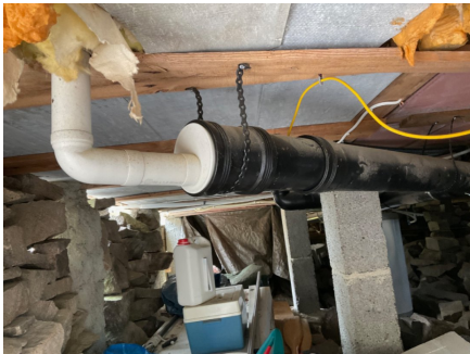
Rørgjennomføring med løsnet isolasjon
