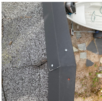
Sprekk i takteking ved beslag ytterst på mønet
