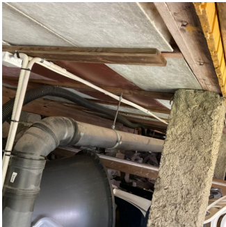
Underside av bjelkelag _ enkelte løse lekter og plater
