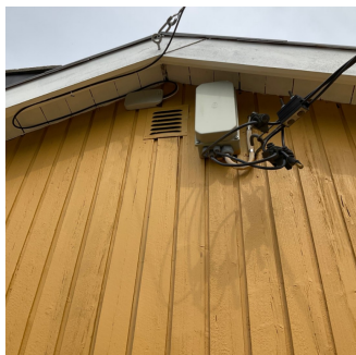
Panelbord med stedvise sprekker
