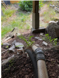
Avløpsrør ført ned i bakken under terrassen ved boligen, videre til felles avløp i hytteveiv og kommunal avløpsnett.
