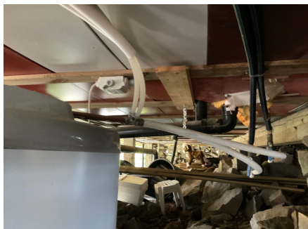
Vannrør av plast i åpent kryperom, stengeventiler på rør til toalett - og badrom
