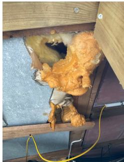
Hull med skade i sementplater _ byggeskum / isolasjon.
