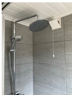
Avtrekksventil på yttervegg ved dusjnise
