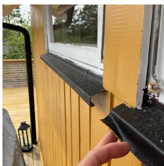
Løsnet folie på beslag ved vannbrett under vindu
