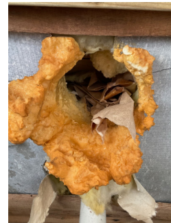
Det er sprekk i plater, hull med byggeskum, papp og isolasjon.
