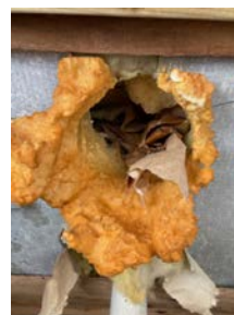
Det er spekk i plater, hull med byggeskum, papp og isolasjon.
