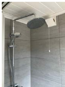
Avtrekksventil på yttervegg ved dusjnise
