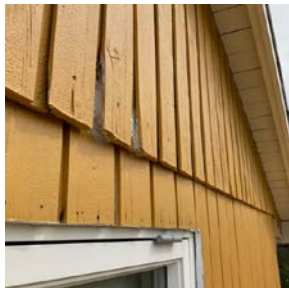
Panelbord som er sprukket og vridd bør skiftes ut for å unngå fuktinntrengning.
