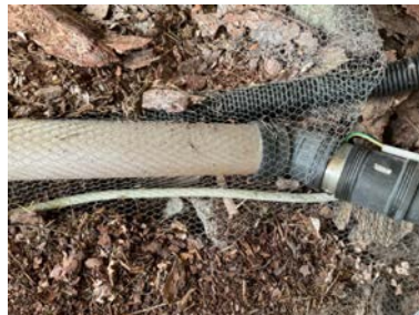
Varmekabel for vannrør er ført ned i bakken under boligen
