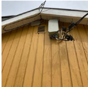
Panelbord med stedvise sprekker
