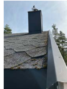
Folierte beslag på vannbord og ved pipe
