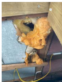
Hull med skade i sementplater _ byggeskum / isolasjon.
