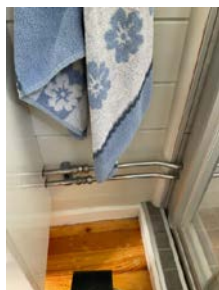
Vannrør med koplinger ført fra servant til dusjnise
