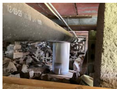
Avløpsrør merket produksjonsår
