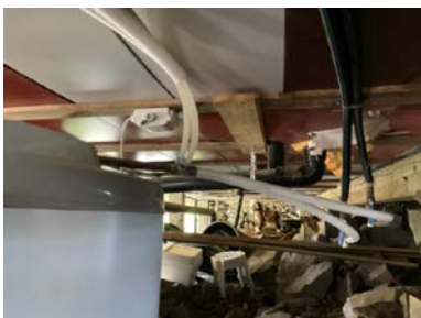
Vannrør av plast i åpent kryperom, stengeventiler på rør til toalett - og badrom
