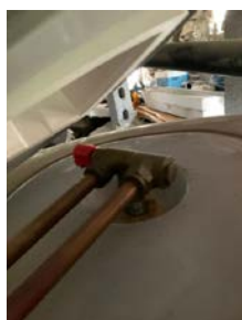
Litt rustutslag ved rørgjennomføring
