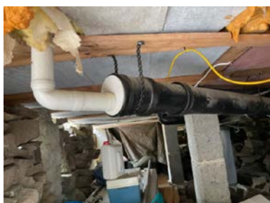
Rørgjennomføring med løsnet isolasjon
