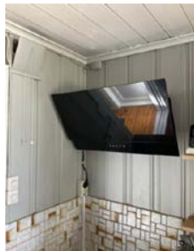
Kjøkkenventilator med kullfilter, avtrekksventil på vegg til vindfang
