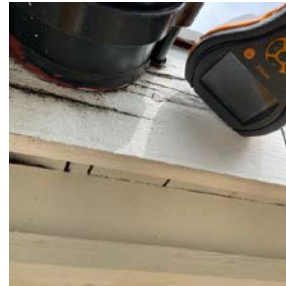
Kantbord ved takrenner som er oppsprukket _ symptomer på fuktskade.
