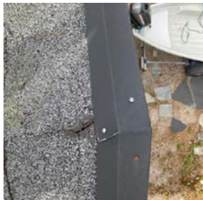
Sprekk i taktekkning ved beslag ytterst på mønet
