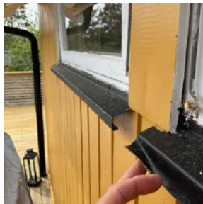
Løstnet folie på beslag ved vannbrett under vindu
