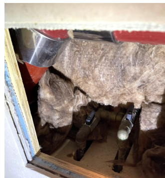
Glimt av hovedavløpsrør i inspeksjonsluke
