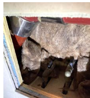
Glimt av hovedavløpsrør i inspeksjonsluke
