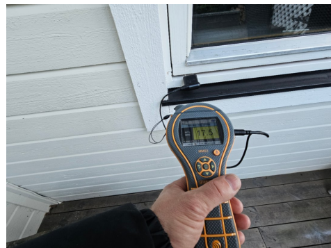
Forhøyet fuktnivå i vindu.
