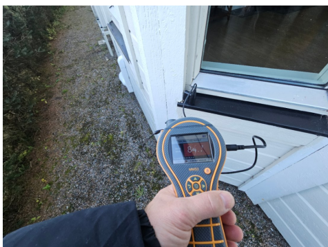
Råteskader ved vindusomramminger.
