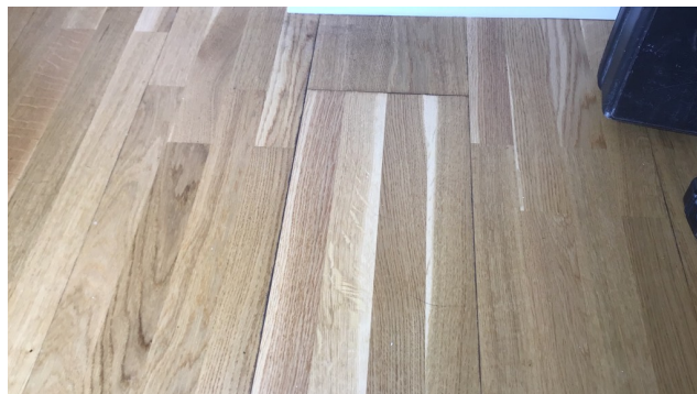
Fukt merker i parkett skjøter
