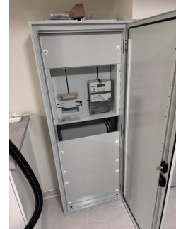
Strømmåler plassert i kjelleren.
