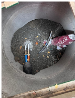
Teknisk brønn under terrasseplatingen på inngangssiden.
