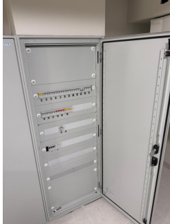
Sikringskapet er plassert i kjelleren.
