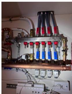
Vannfordelere til gulvvarmen for kjelleren og 1. etasje er montert i kjelleren.
