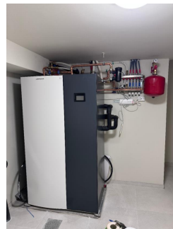
Varmepumpe montert i kjelleren.
