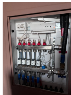
Vannfordelere til gulvvarmen 2. etasje er montert i vegg mot badet på det ene soverommet i 2. eta
