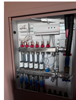
Vannfordelere til gulvvarmen 2. etasje er montert i veggen mot badet på det ene soverommet i 2. eta
