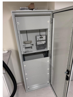
Strømmåler plassert i kjelleren.
