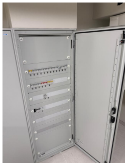
Sikringskapet er plassert i kjelleren.
