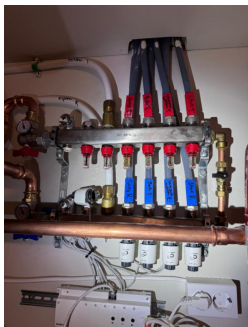
Vannfordelere til gulvvarmen for kjelleren og 1. etasje er montert i kjelleren.
