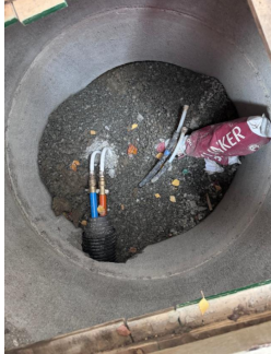
Teknisk brønn under terrasseplatingen på inngangssiden.
