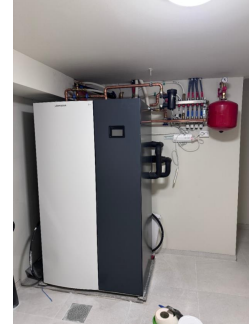
Varmepumpe montert i kjelleren.
