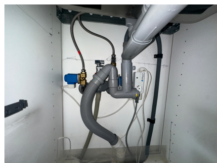
Røropplegg i kjøkkenbenk med Waterguard
