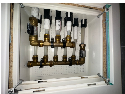
Samleskap for vannrør på bad
