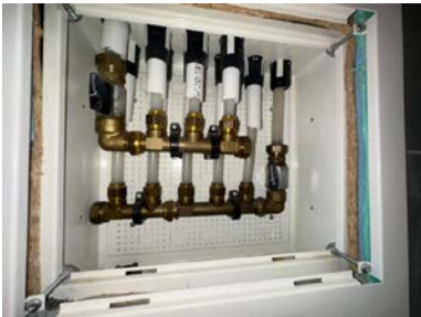
Samleskap for vannrør på bad
