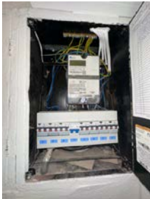
Sikringsskap plassert i felles oppgang.
