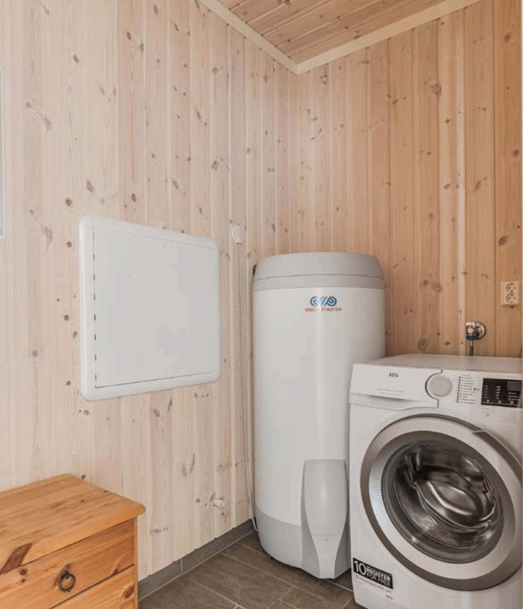
Praktisk med et separat vaskerom med flislagt gulv med varmekabler i.
