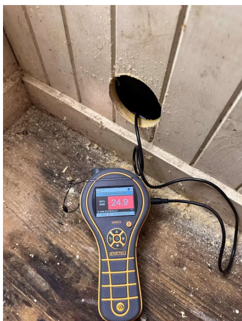
Fuktmåling i grovkjeller utlektet vegg (under terreng)
