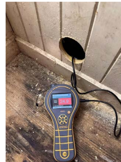
Fuktmåling i grovkjeller utlekket vegg (under terreng)
