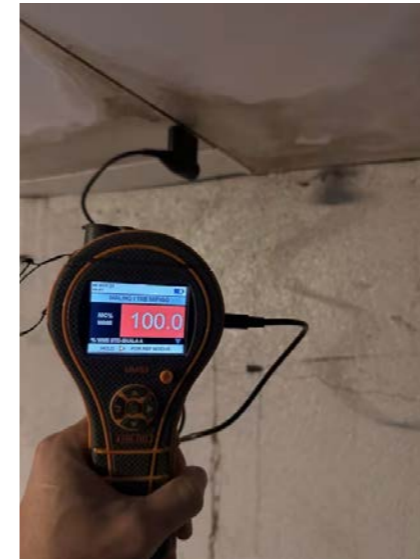
Fuktmåling i grovkjeller tak (under stue)
