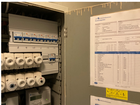
Sikringsskap i felles trappegang
