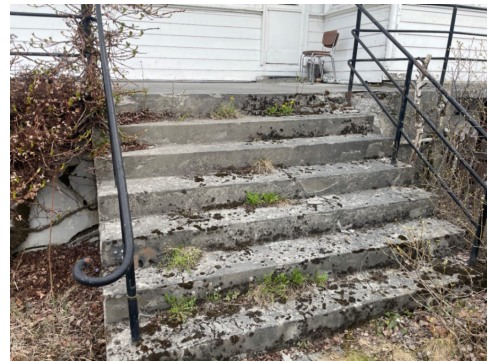
Riss og mindre sprekker i overflater
