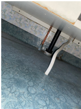
Ufaglig rørgjennomføring i våtsone gulv
