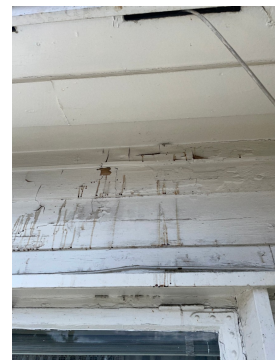
Synlig fuktmerker ved raft. i hjørne ved gradrenne
