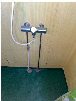
Ufaglig rørgjennomføring i våtsone til gulv
