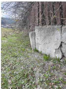
Synlige skader og setninger i støttemur.
