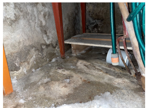
Saltutslag og fukt på vegg og gulv
