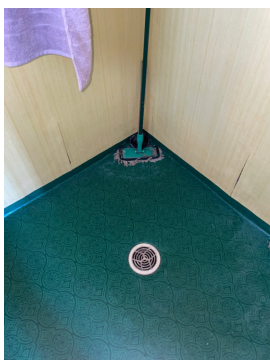
Sluk og synlig fuktskader på vegg
