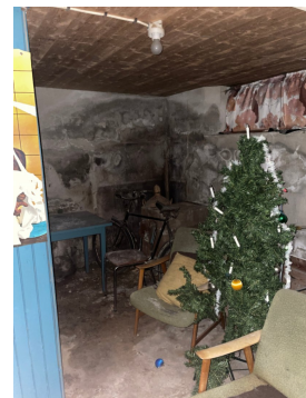
Fuktgjennomslag på murvegg.
