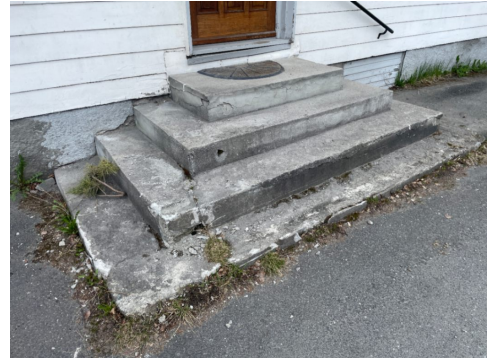
Riss og mindre sprekker i overflater
