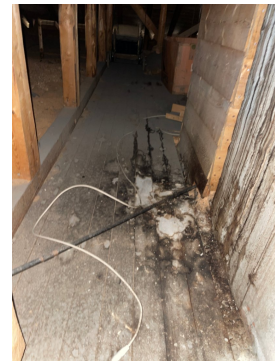
Fuktmerker på gulv. Må undersøkes nærmere
