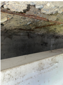
Rustpreng i armering til terrasse.
