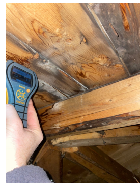
Fuktmerker og noe svertesopp på bordtro.
