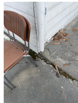
Manglende kontrollert bortledning av takvann ved mur
