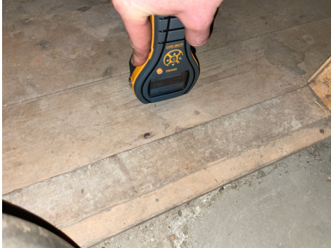
Høye fuktverdier i treverk.
