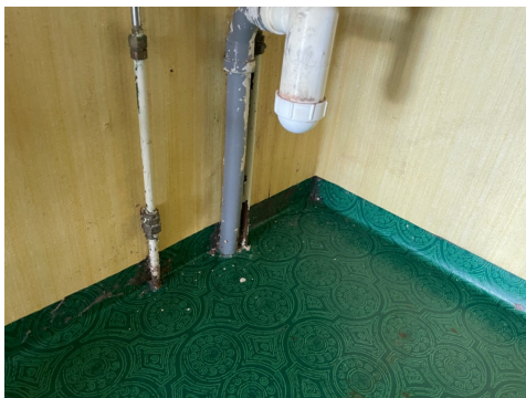
Ufaglig rørgjennomføring i våtsone til gulv
