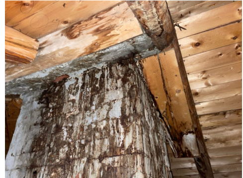
Fuktmerker rundt pipegjennomføring
