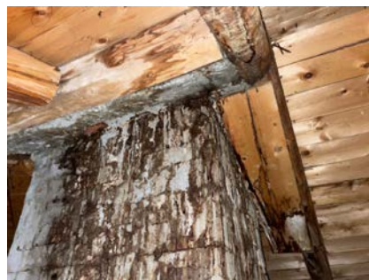
Fuktmerker rundt pipegjennomføring
