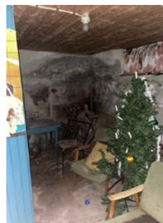
Fuktgjennomslag på murvegg.
