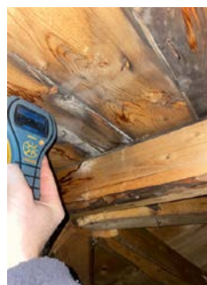
Fuktmerker og noe svertesopp på bordtro.
