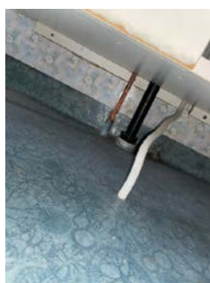
Ufaglig rørgjennomføring i våtsone gulv
