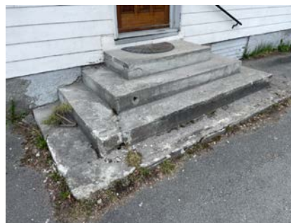
Løst terskel beslag/bord.
