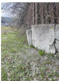
Synlige skader og setninger i støttemur.
