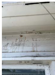
Synlig fuktmerker ved raft, i hjørne ved gradrenne
