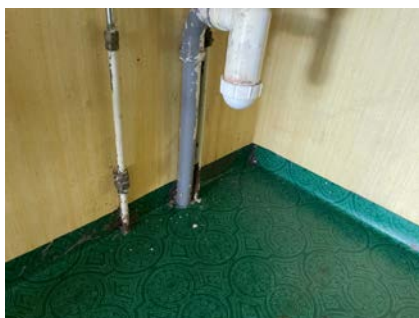
Ufaglig rørgjennomføring i våtsone til gulv
