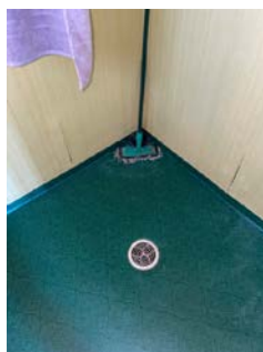
Sluk og synlig fuktskader på vegg
