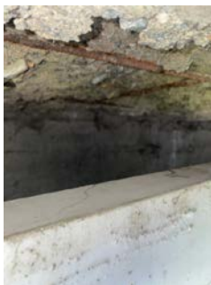
Rustpreng i armering til terrasse.
