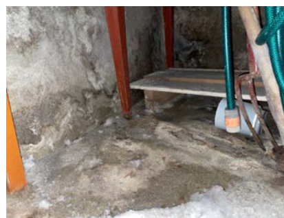
Saltutslag og fukt på vegg og gulv
