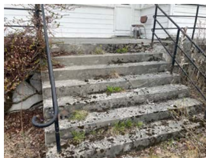
Riss og mindre sprekker i overflater
