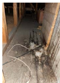
Fuktmerker på gulv. Må undersøkes nærmere
