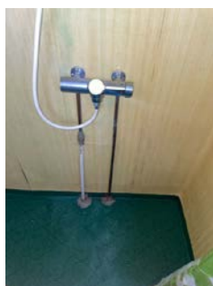
Ufaglig rørgjennomføring i våtsone til gulv
