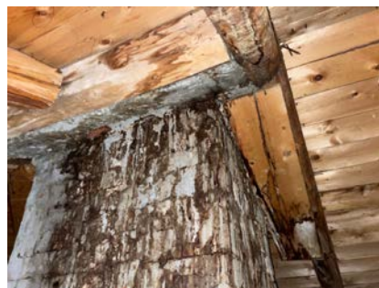
Fuktmerker rundt pipegjennomføring
