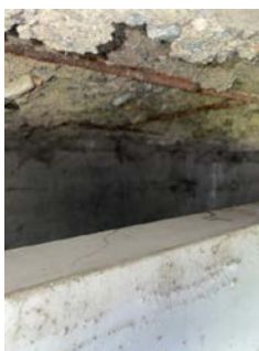
Rustpreng i armering til terrasse.
