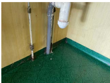
Ufaglig rørgjennomføring i våtsone til gulv
