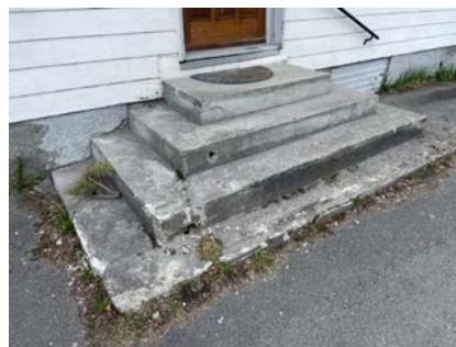
Riss og mindre sprekker i overflater
