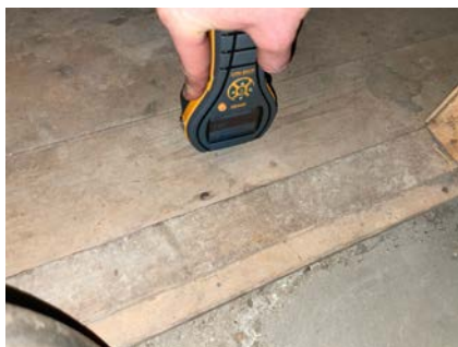
Høye fuktverdier i treverk.
