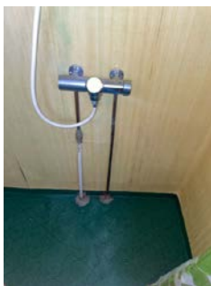
Eksempel på irr på rør funnet på bad
