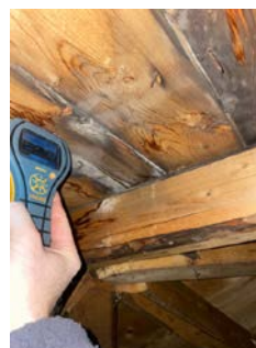
Fuktmerker og noe svertesopp på bordtro.
