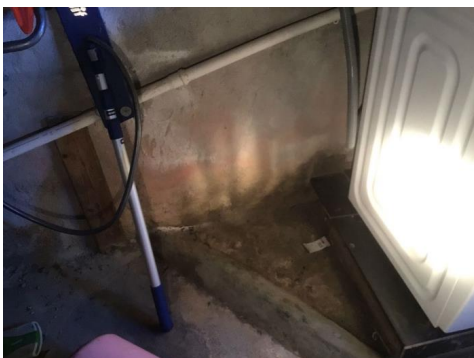
Fukt langs vegger
