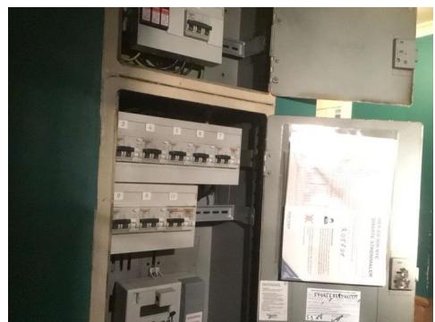
Sikringsskapet plassert i gang
