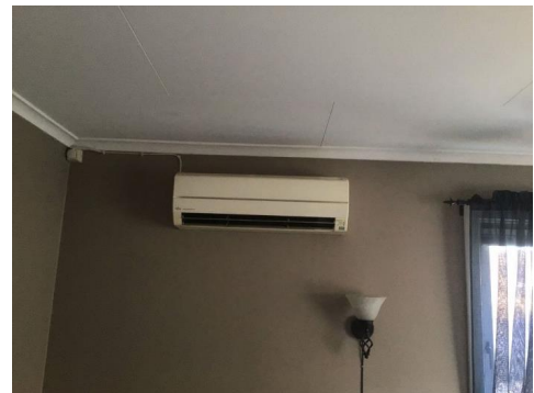
Varmepumpe i stue.
