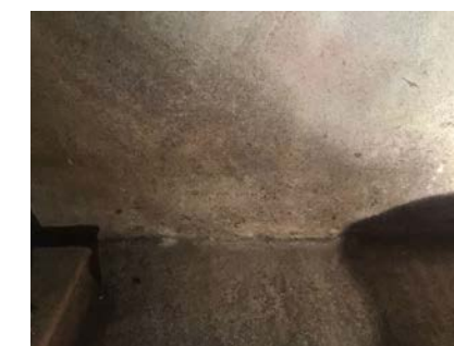
Noe saltutslag og fuktmerker
