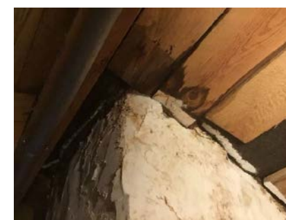
Eldre fuktmerker ved pipe
