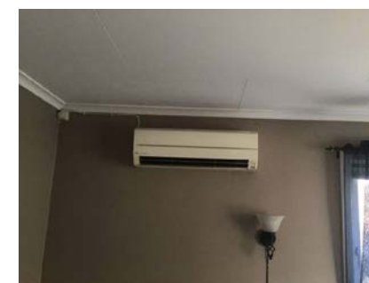
Varmepumpe i stue.
