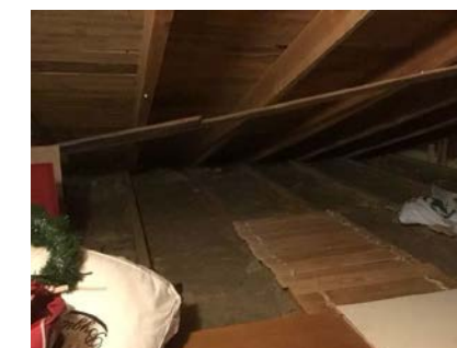
Mangler luftespalte i nedkant
