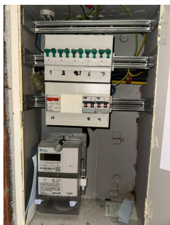
Sikringsskap med automatsikringer.
