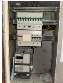
Sikringsskap med automatsikringer.
