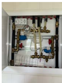
Samleskap for vannrør på bad plan 1
