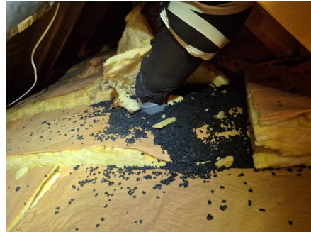
Isolasjon er skadet/gnagd bort.
