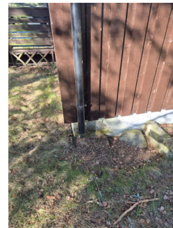
Mangler bortledning av takvann.
