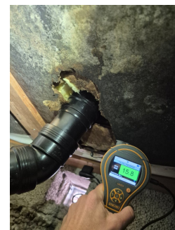
Målt vektprosent på 15,8 % i treverk under bad.
