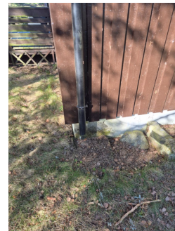
Mangler bortledning av takvann.
