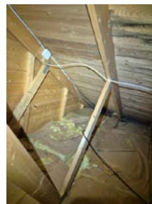
Ledninger på loft som ikke er tilstrekkelig festet.
