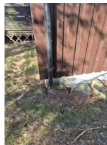
Mangler bortledning av takvann.
