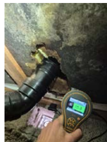
Målt vektprosent på 15,8 % i treverk under bad.
