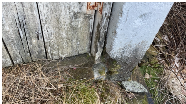
Forvitring på grunnmur og dør til kryprom er slitt og bør skiftes
