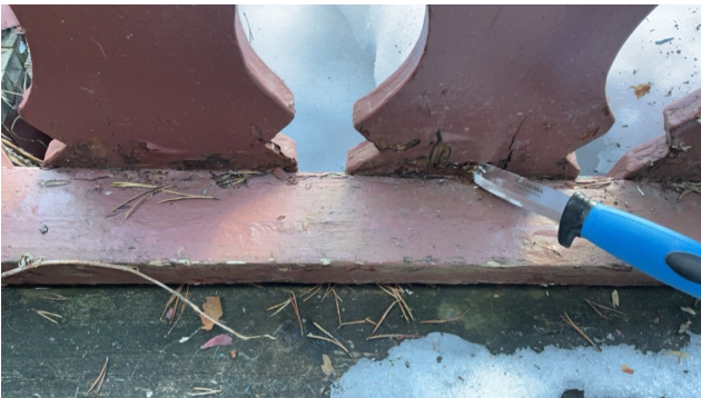
Det er registrert råte i spil på rekkverk, der nærmere undersøkelser av konstruksjoner i son helhet må foretas
