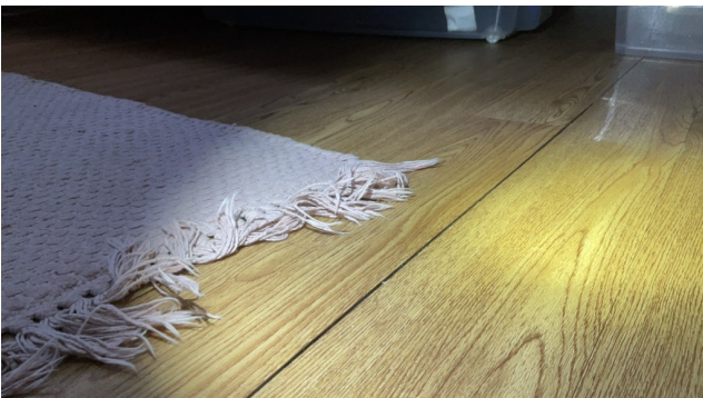
Glipper i skjøter på laminat
