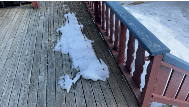
Vedlikeholdsbehov og skjevheter på terrasse/inngangsparti
