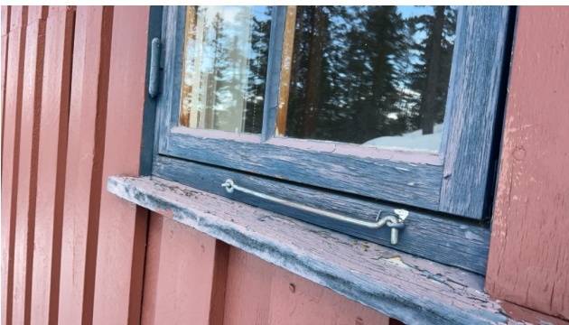
Slitasje med vedlikeholdsbehov
