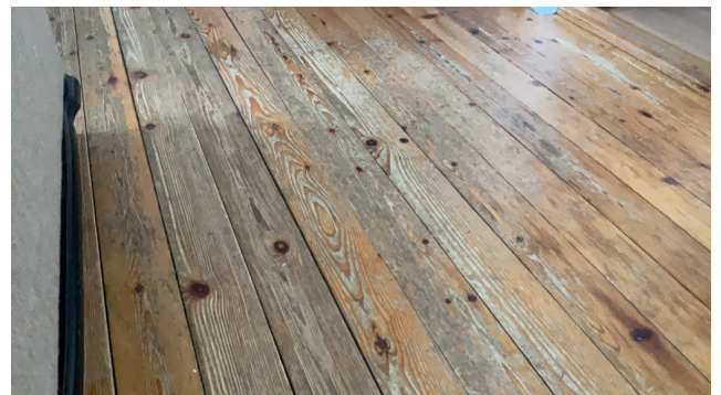
Gulv spesielt i stue og entre har slitasje der slip og overflatebehandling må foretas
