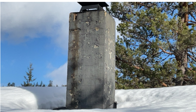
Avflassing og spekkdannelse på pipe over tak
