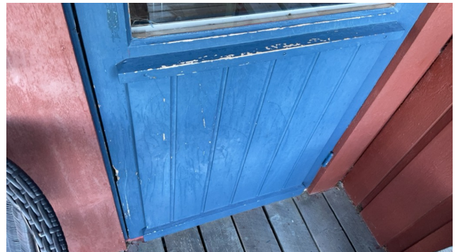
Slitasje og skader på terrassedør
