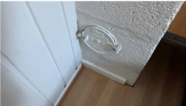
Avstand fra sotluke til brennbart materiale er for kort både mot veggkonstruksjon og manglende plate på gulv eller sotlukestein
