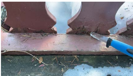
Det er registrert råde i spil på rekkverk, der nærmere undersøkelser av konstruksjoner i son helhet må foretas
