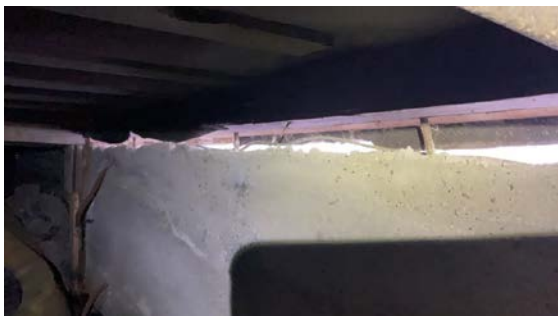
Synk mellom grunnmur og bærekonstruksjon, glipper i overgang bygning og mur med synlig armering som forankring og nærmere undersøkelse bør foretas
