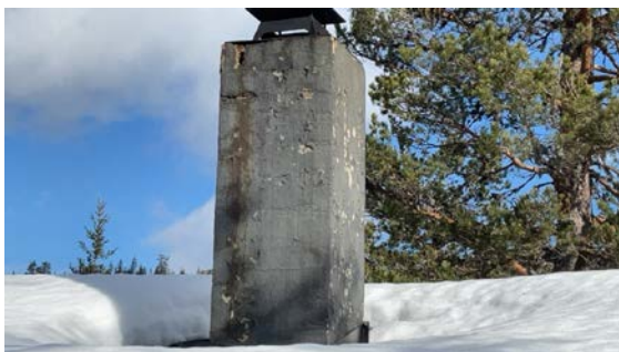
Avflassing og spekkdannelse på pipe over tak
