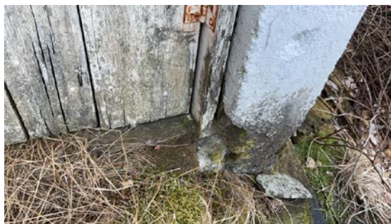
Forvritning på grunnmur og dør til krypprom er slitt og bør skiftes
