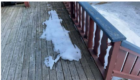
Vedlikeholdsbehov og skjevheter på terrasse/inngangsparti
