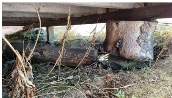
Ulik fundamenteringsmetode og utsatt for setninger fra grunn
