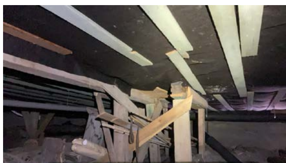
Kan sees mugg på papp mot gulvkonstruksjon, samt glipper i overgang mot gulvkonstruksjon og spor av aktivitet av mus/skadedyr der det er fare for åpninger til skadedyr i bygnig. (ukjent tilstand i lukkede konstruksjoner og må hensyntas)
