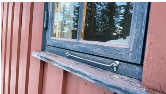
Slitasje med vedlikeholdsbehov
