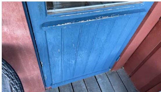
Slitasje og skader på terrassedør
