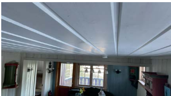
Skjevheter i himling/konstruksjoner, følgeskader med årsak er setninger i bygning fra grunnforhold og fundamenteringsmetode
