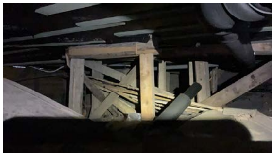
Enkel oppstøtning, langt spenn der tiltak bør foretas
