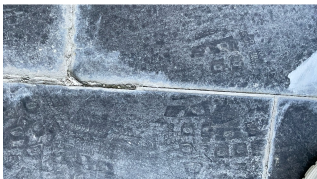
Sprekk i flisfuger. Løse fliser.
