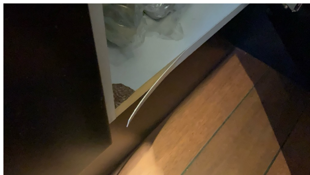
Løs list og skade i kjøkkenskrog.
