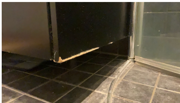
Svell/fuktskader på innredning
