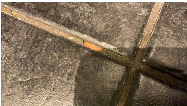
Hull i flisfuger i våtsonen.
