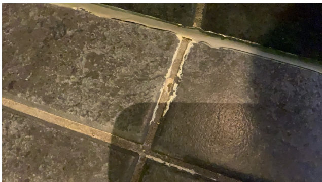
Hull i flisfug i våtsonen.
