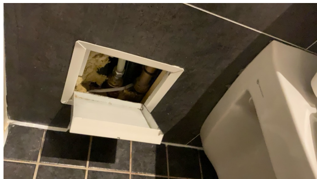
Vannstoppledning går inn innspeksjonsluke.
