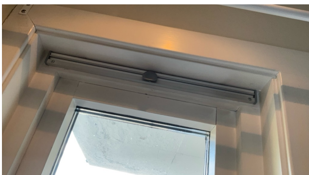
Ventiler i vindu.
