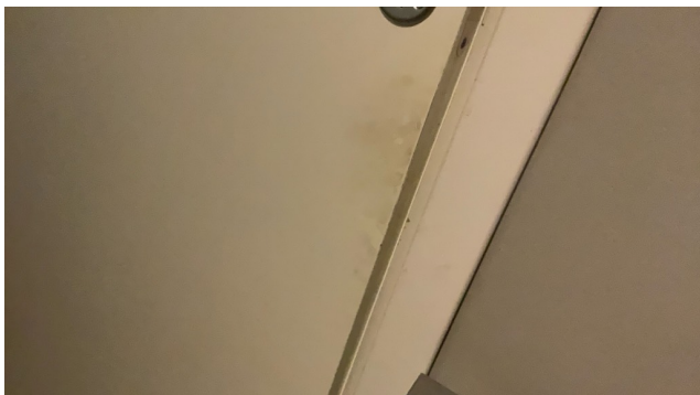
Missfarging på dørblad.
