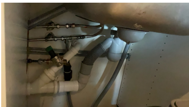
Avløpsrør av plast.
