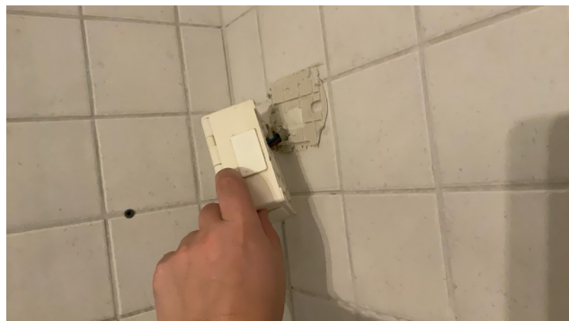
Stikk på våtrom ikke tilstrekkelig festet.
