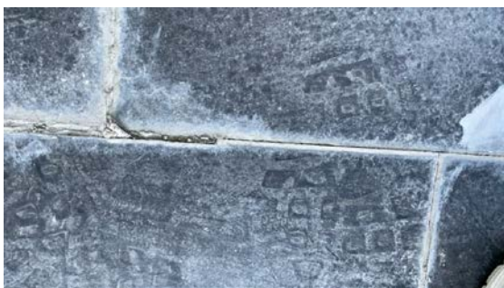
Sprekk i flisfuger. Løse fliser.
