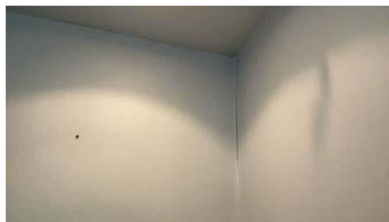
Oppsprekking i hjørne og overgang vegg/tak.
