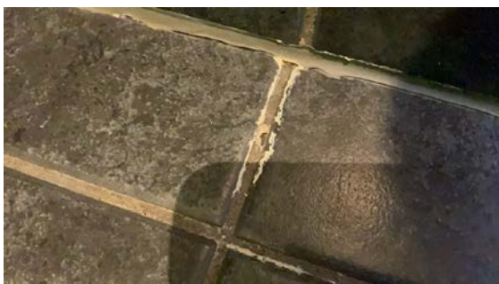
Hull i flisfug i våtsonen.
