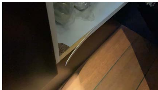
Løs list og skade i kjøkkenskrog.
