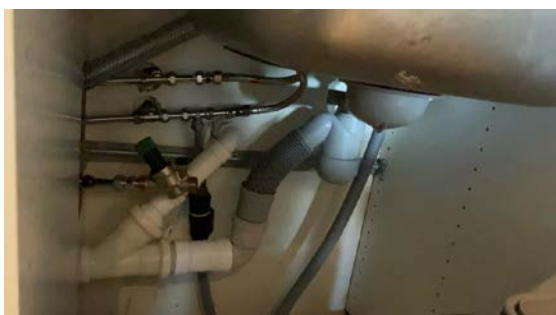
Avløpsrør av plast.
