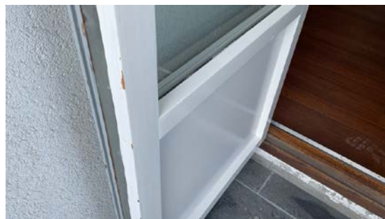
Skader i terrassedør.
