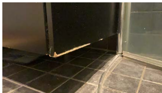
Svell/fuktskader på innredning
