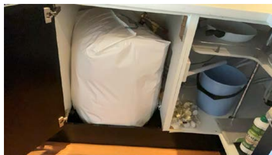
Bereider under kjøkkenbenk.
