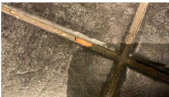
Hull i flisfuger i våtsonen.
