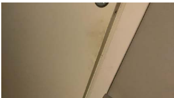
Missfarging på dørblad.
