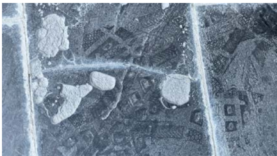
Sprekker i fliser.
