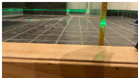
Det er målt 8,5cm på gulv ved terskel.
