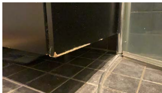
Svell/fuktskader på innredning
