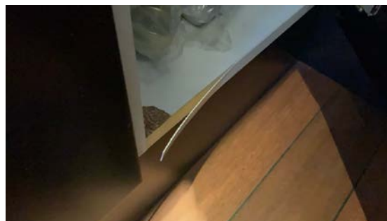
Løs list og skade i kjøkkenskrog.
