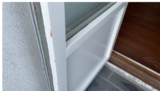
Skader i terrassedør.
