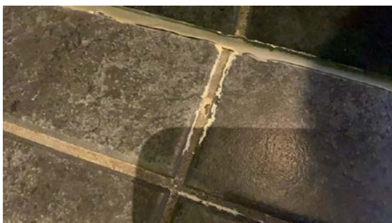
Hull i flisfug i våtsonen.
