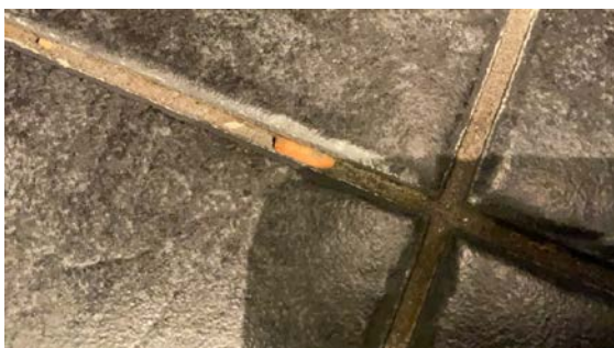
Hull i flisfuger i våtsonen.
