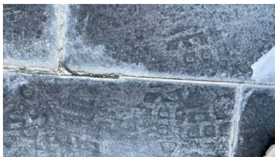
Sprekk i flisfuger. Løse fliser.
