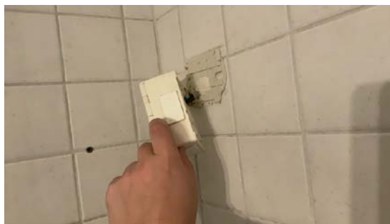
Stikk på våtrom ikke tilstrekkelig festet.
