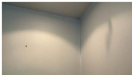
Oppsprekking i hjørne og overgang vegg/tak.
