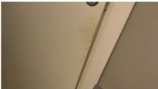
Missfarging på dørblad.
