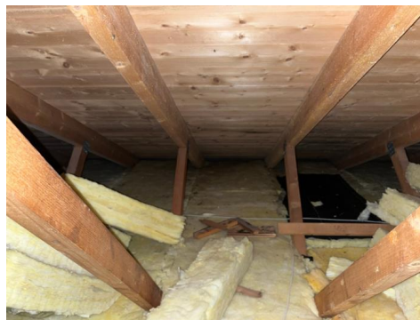
Fuktmerker i takstol.
