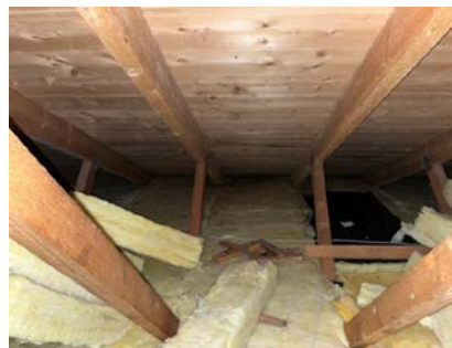
Fuktmerker i takstol.
