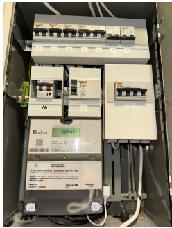
Sikringskap med automatsikringer.
