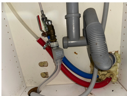
Rørproppleg i kjøkkenbenk
