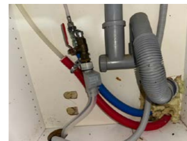
Røropplegg i kjøkkenbenk
