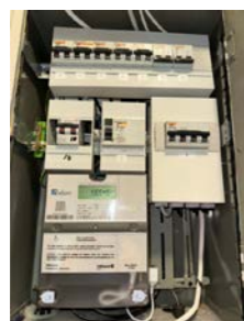
Sikringskap med automatsikringer.
