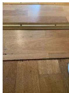
Det er påvist svikt i parkett ved trapp mot gang.
