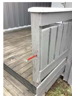
Råteskadet rekkverk ved vaskerom.
