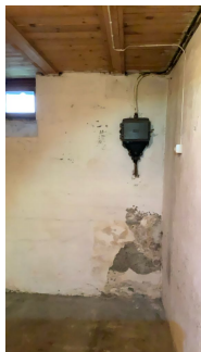
Hovedsikringer plassert i kjellerbod
