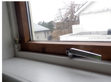
Ikke mulig å åpne vindu bad 2. etasje
