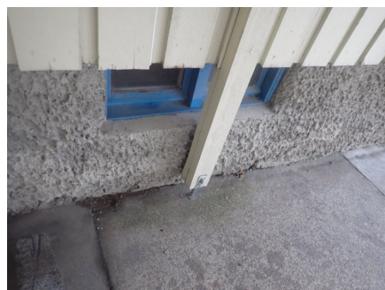
Manglende beslag under vinduer i mur
