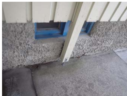
Manglende beslag under vinduer i mur
