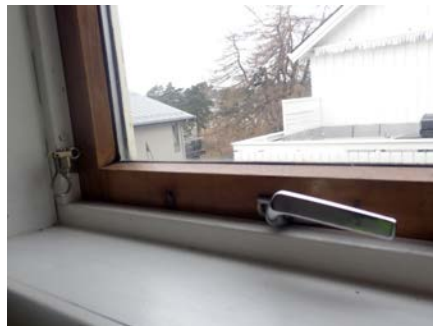
Ikke mulig å åpne vindu bad 2. etasje
