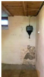
Hovedsikringer plassert i kjellerbod
