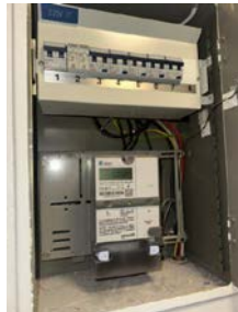
Sikringsskap plassert i felles oppgang.
