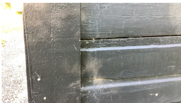
Liggende kledning har krympet, og det kan komme inn regnvann.
