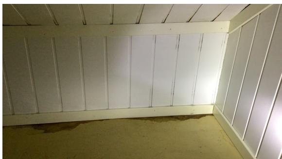
Skråtaket går helt ned til yttervegg. Bildet viser tidligere kondensskade innerst i klesskap. Anbefaler videre undersøkelser.
