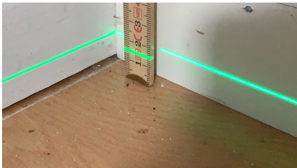
Det er målt 25 mm høydeforskjell i stue.
