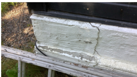
Det er registrert sprekker i muren utvendig.
