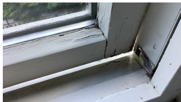
Enkelte vinduer har kondensmerker.
