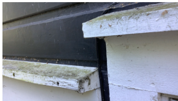
Manglende beslag inn i kledning over vindu/dør.
