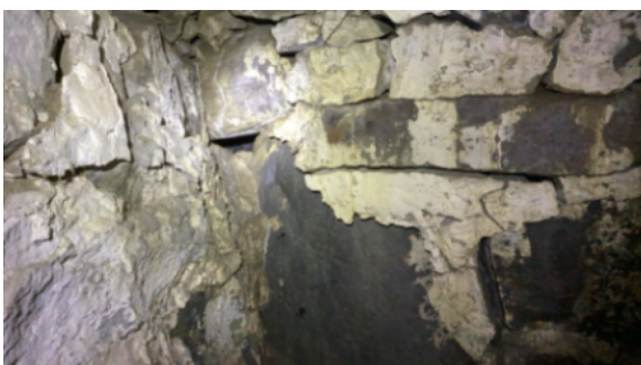
Det er registrert sprekker og setninger fra innside mur
