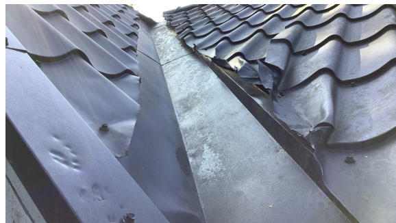
Beslag og takplater er deformert i gradrenne.
