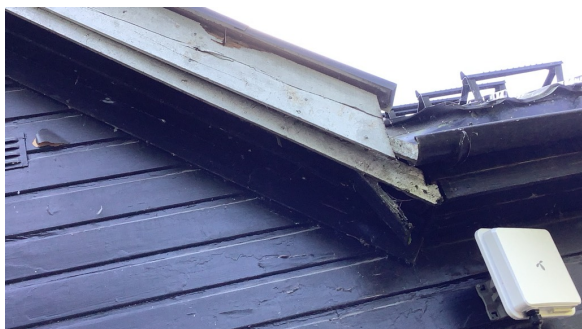
Vindskier bærer preg av råte og har løsnet enkelte steder.
