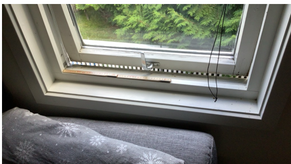
Vindu på sovealkove på loftetasje er for lite til rømningsveg og lysinnfall.
