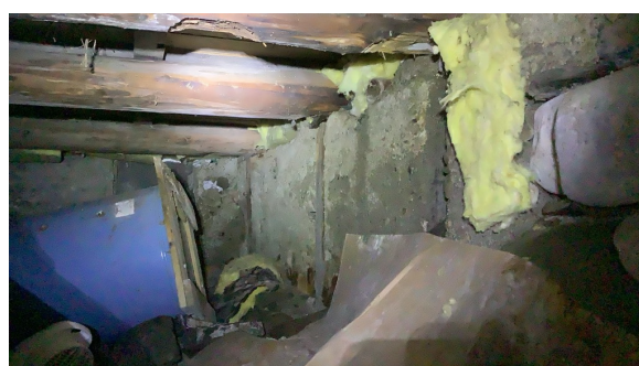
Deler av etasjeskiller er uten isolasjon. Råteskade er registrert.
