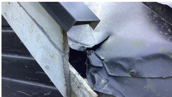
Løstet vindski etter ising på vinter.
